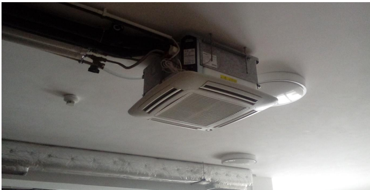
Zdj. 18. Klimakonwektor sufitowy Aermec
