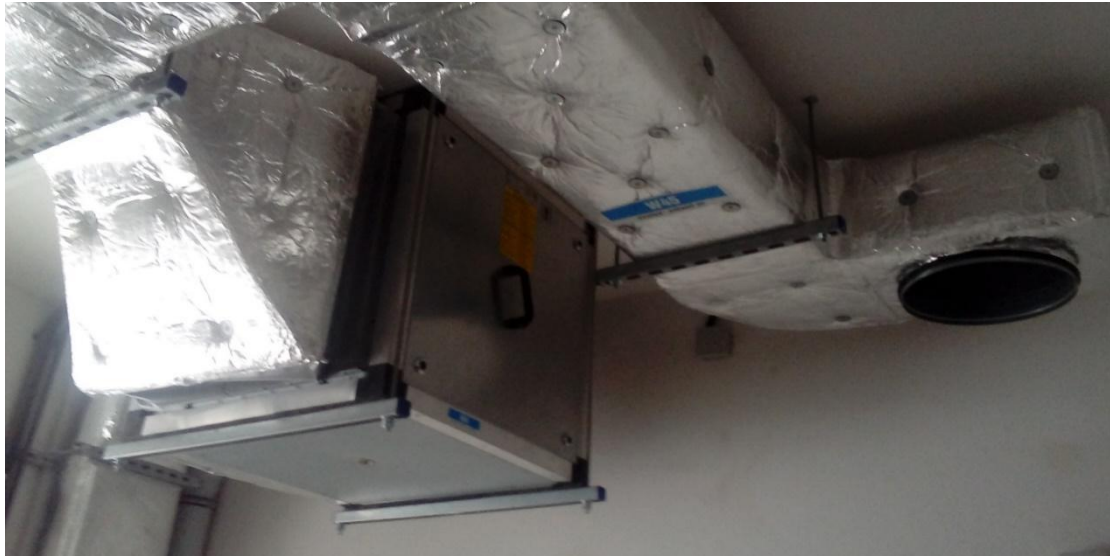
Zdj. 20. Wentylator wyciągowy – W45
