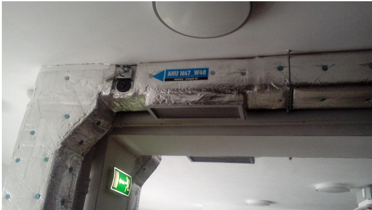
Zdj. 17. Kanały wentylacyjne – centrala N47W48
