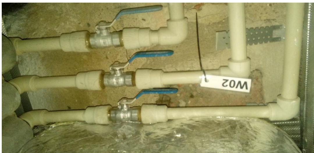
Zdj. 19 Zawory odcinające.
