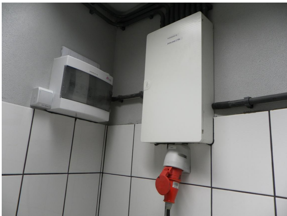
Zdj. 8 Rozdzielnia TB i TBa.
