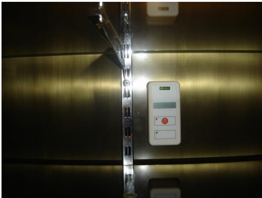
Zdj. 16 Sygnalizator alarmowy.
