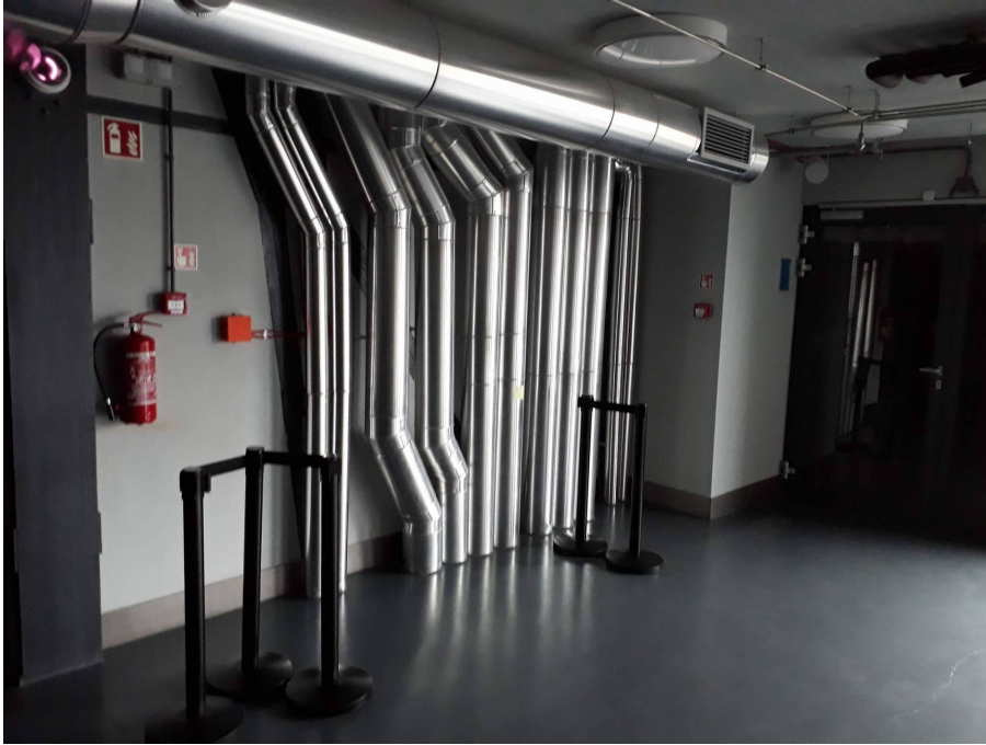
Zdj. 7 Widok blaszanych płaszczy instalacji
